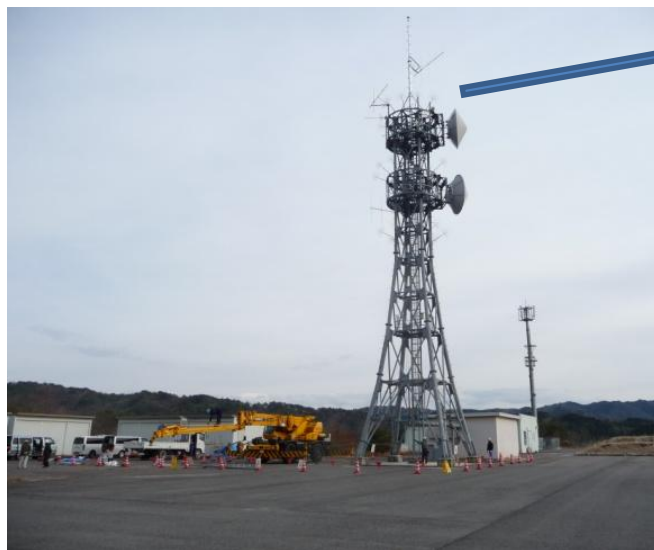
庄内川河川事務所 小里川ダム無線鉄塔
